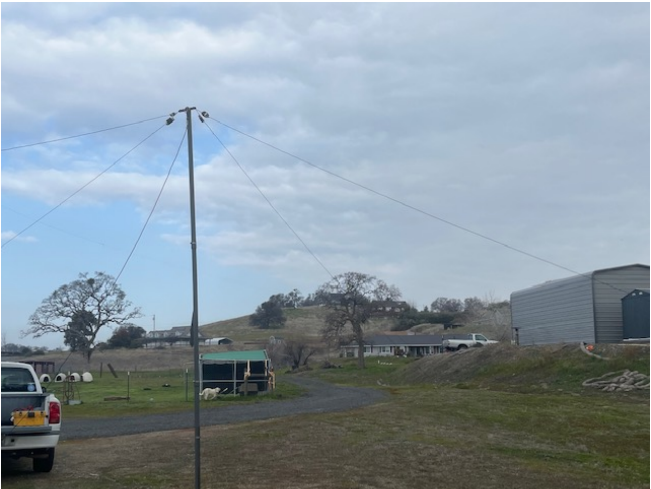
N6AXQ , NVIS Antenna
