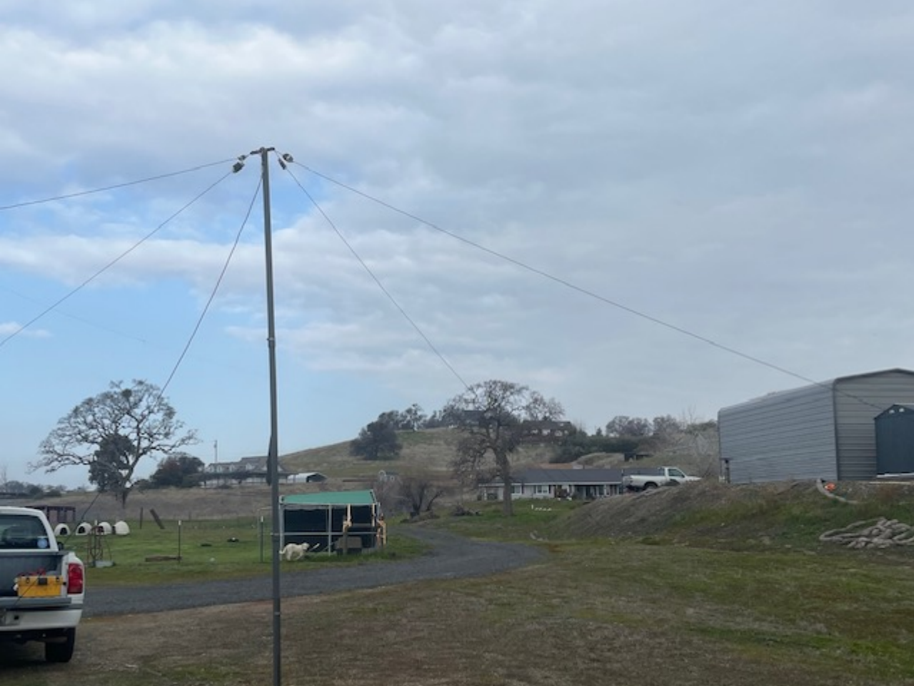
N6AXQ , NVIS Antenna
