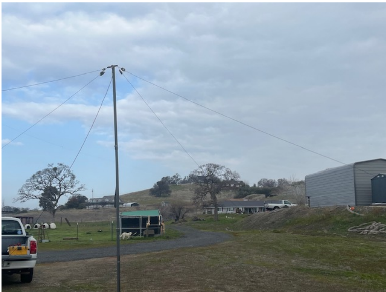
N6AXQ , NVIS Antenna
